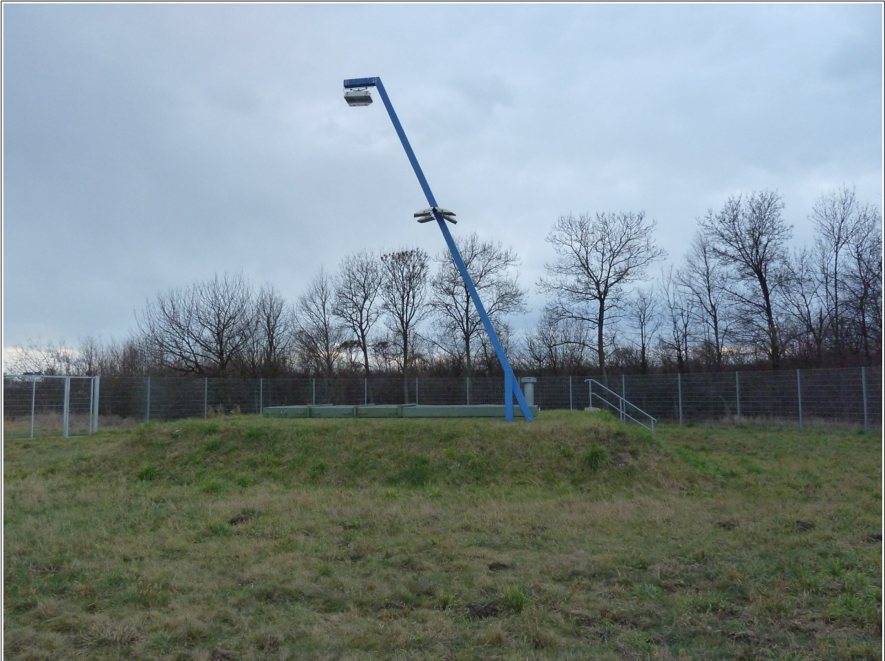
Abbildung 3.1.2: Eines von insgesamt sechs Pumpwerksarealen vor der Installation eines Lichtmastes (© Martin Soneira, Januar 2012)
